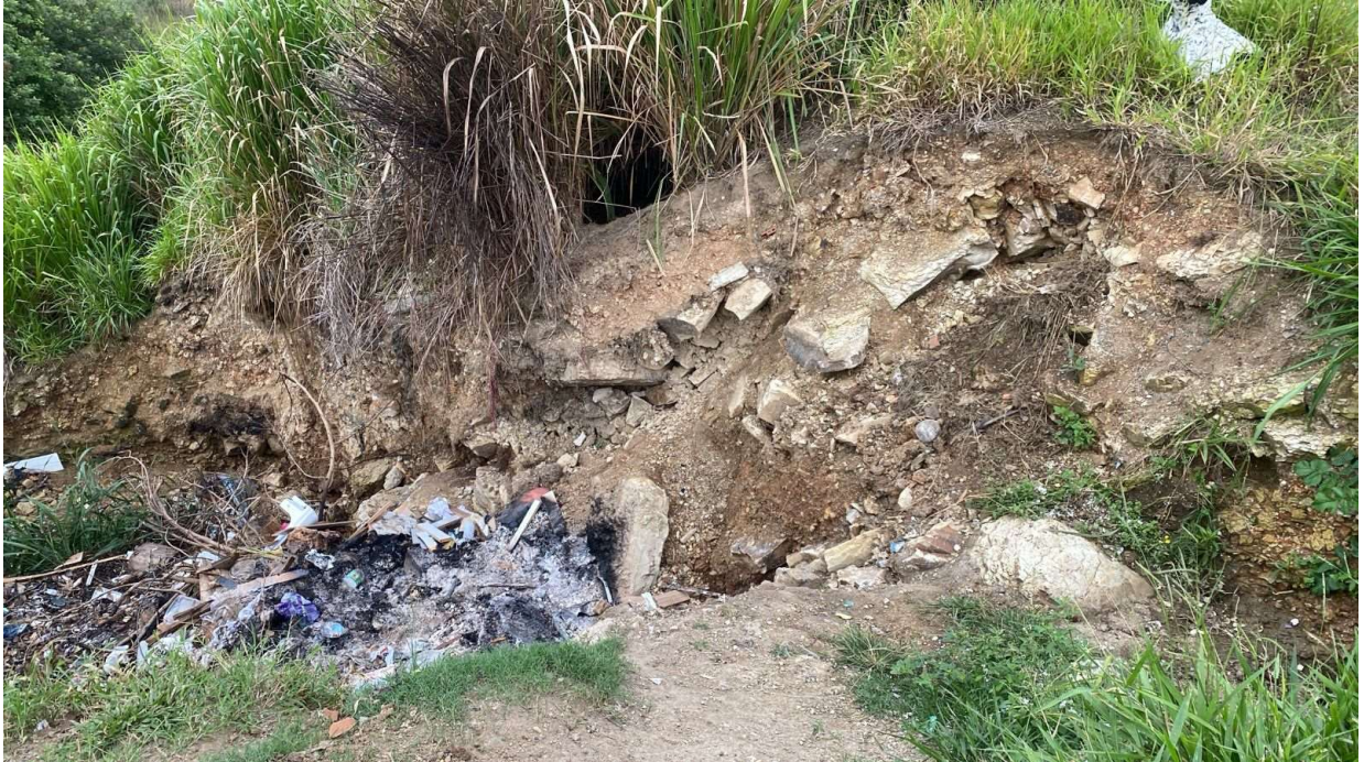
Imagem 19 – Foto de locais sem infraestrutura sofrendo erosão.
